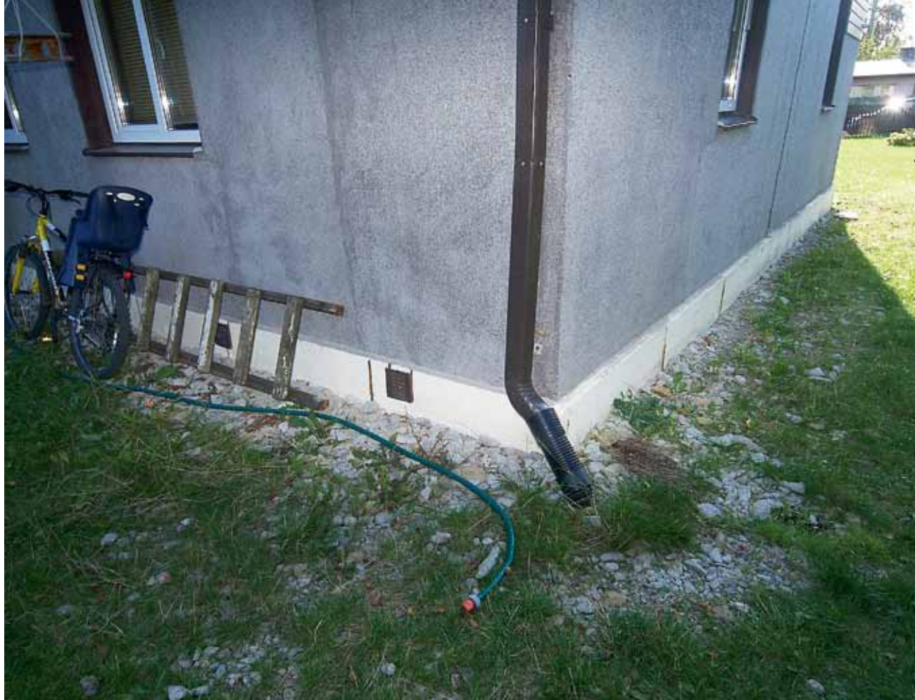
TALLINNAS Pirita linnaosas asuv maja, mis läbis majavammi tõttu 2010. aastal kapitaalremondi. Millise kahjustusega täpselt tegu, näitasid hoone ventilatsioonivadest võetud proovid. FOTO: ERAKOGU
